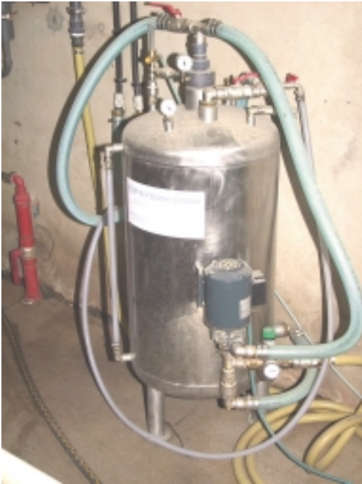
Anlage zur Sauerstoffanreicherung von Trinkwasser
