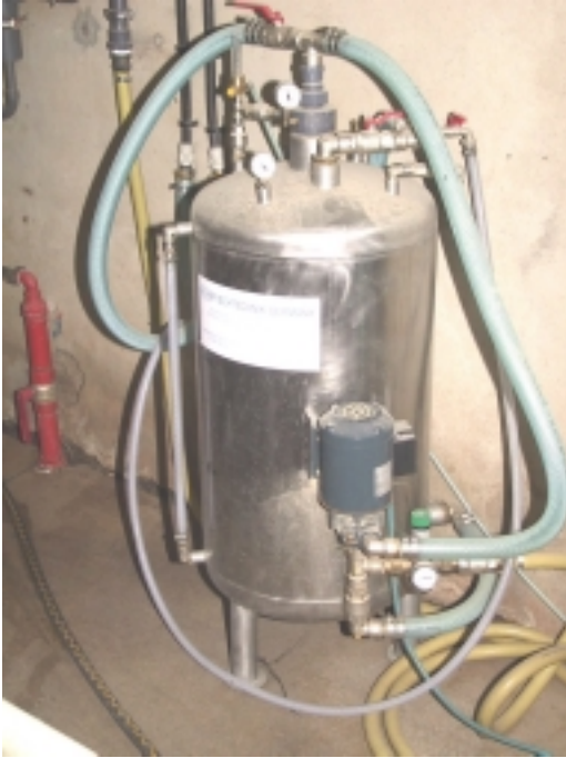
Anlage zur Sauerstoffanreicherung von Trinkwasser
